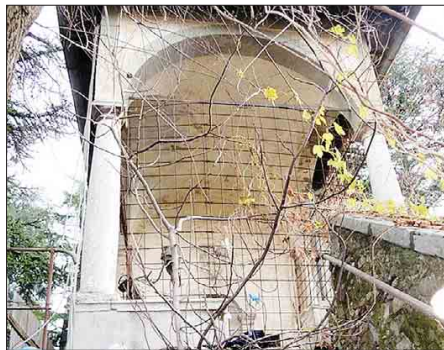
La cappella in stato di degrado in salita Manci
